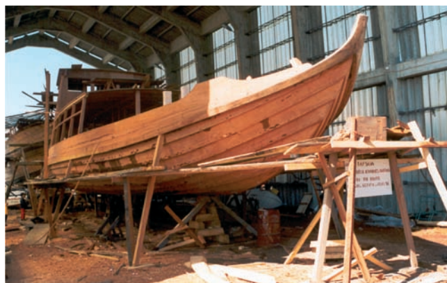
Estaleiros Navais Samuel e Filhos Lda. Construção de um Barco Rabelo para turismo náutico no rio Douro. Fotografado em 1999
